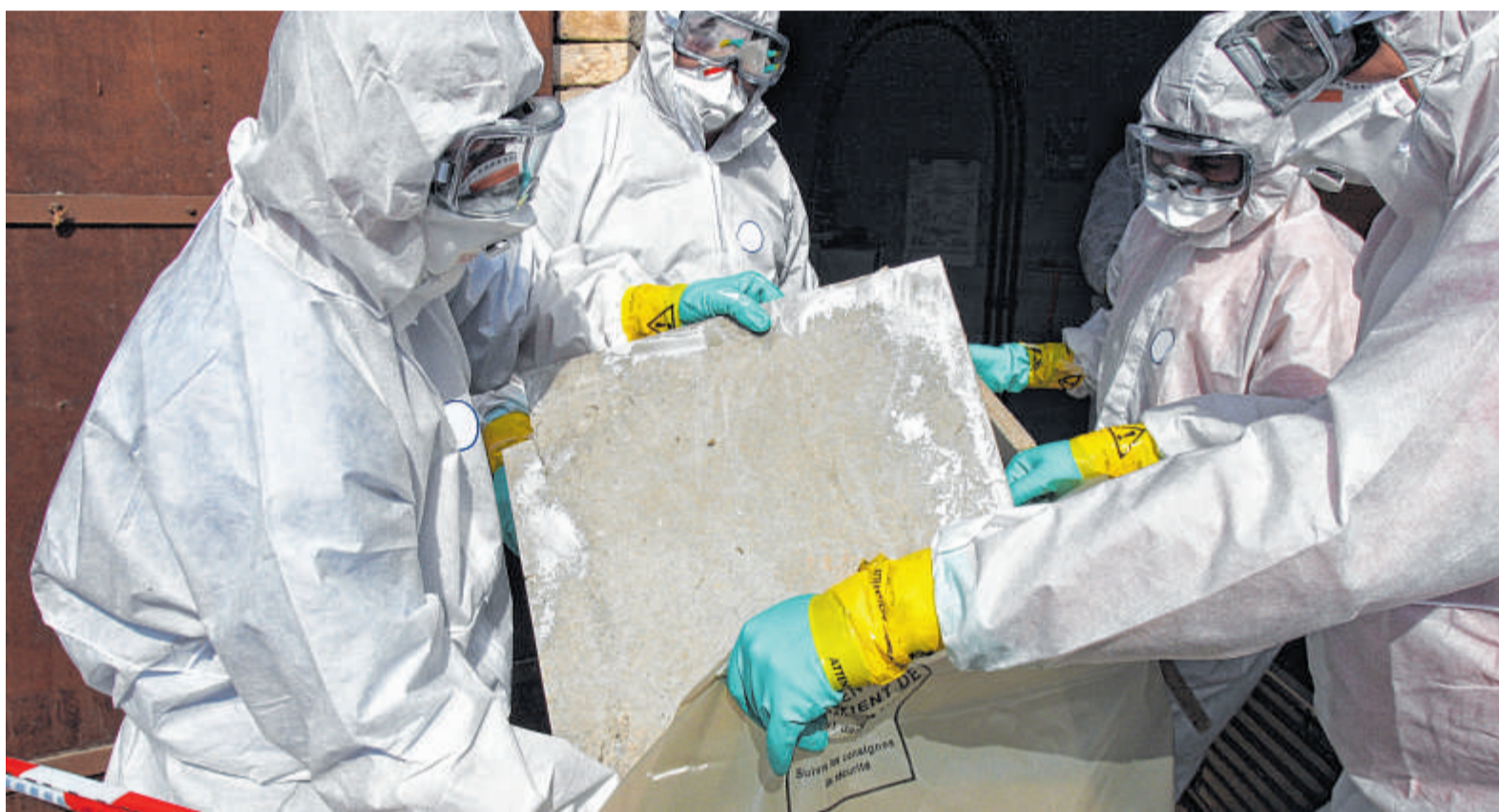
Asbest ist ein hochtoxischer Baustoff. Viele Bauarbeiter und Handwerker sind erkrankt, weil die Krebsgefahr anfangs nicht bekannt war.
